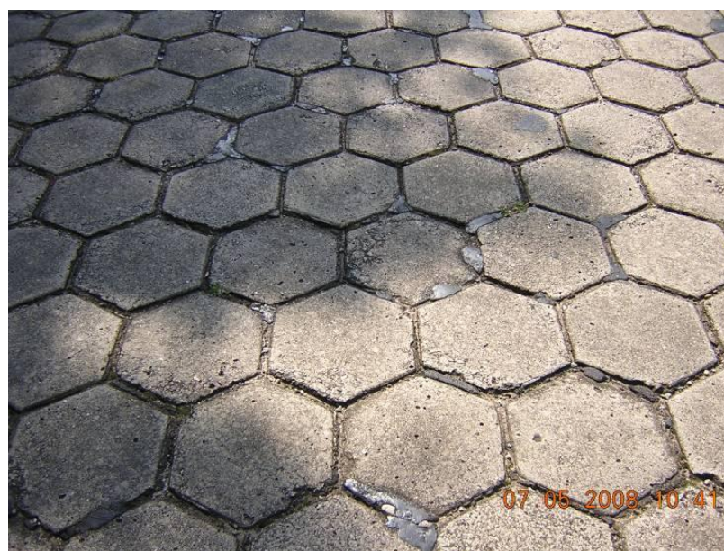
Foto 30: Ninhos preenchidos com asfalto (fonte: Autores)
