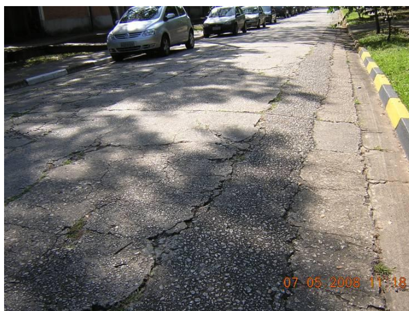
Foto 50: Placa de concreto danificada. (fonte: Autores)
