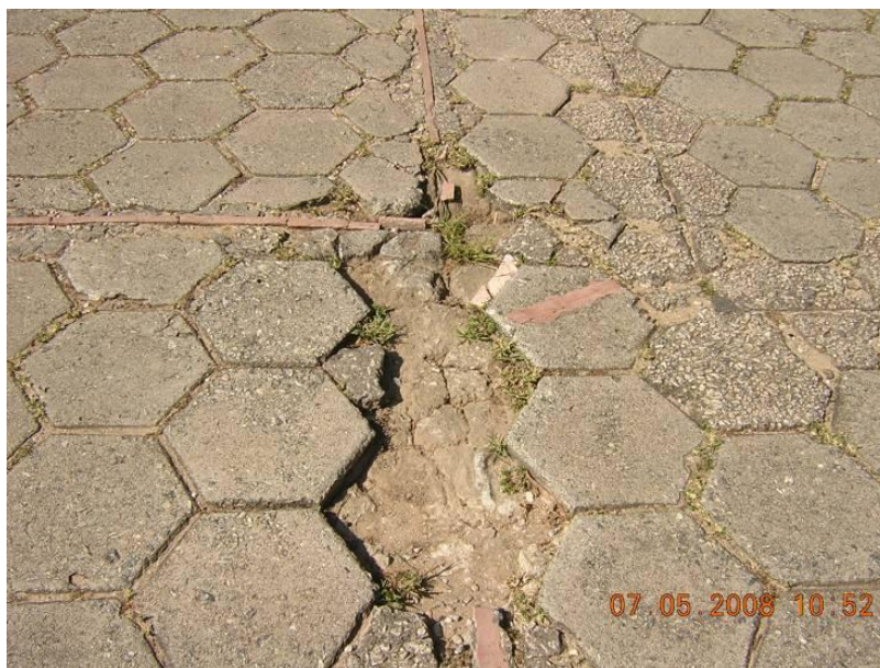
Foto 35: Ausência de blocos, blocos trincados, quebrados e desgastados (fonte: Autores)
