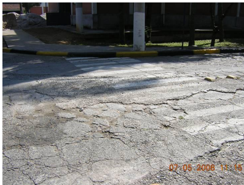
Foto 45: Rotatória – Trinca e quebra da placa de concreto. (fonte: Autores)
