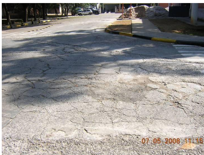
Foto 46: Rotatória – Trinca e quebra da placa de concreto. (fonte: Autores)
