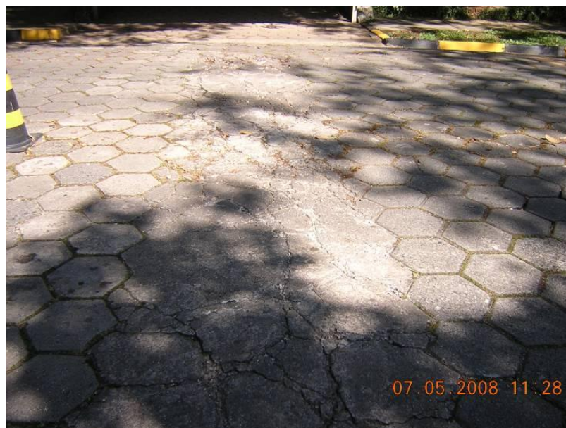
Foto 41: Reforma com substituição de tubulação enterrada, com revestimento diferente do original. (fonte: Autores)
