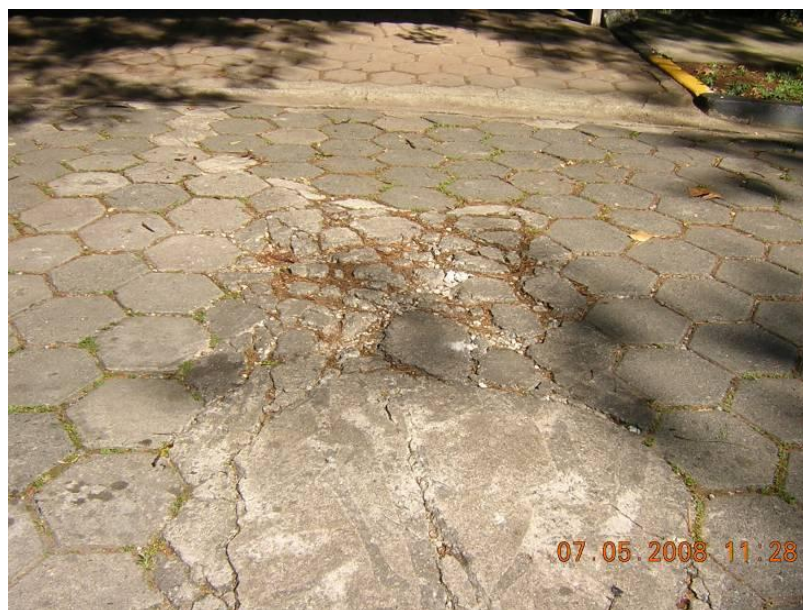
Foto 42: Reforma com remoção de uma lombada, o que deixou muito resíduo sobre a pista, assim como blocos quebrados e trincados. (fonte: Autores)
