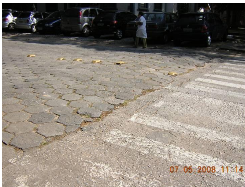
Foto 32: Lombada com desgaste superficial, quebra de borda, Ninho preenchidos de vegetação e desnível de borda. (fonte: Autores)
