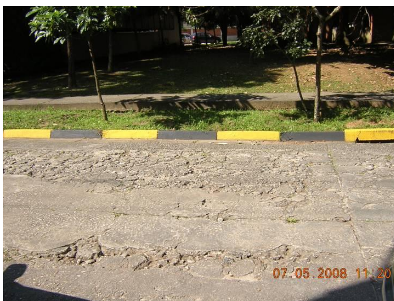
Foto 52: Buraco devido à placa de concreto quebrada. (fonte: Autores)
