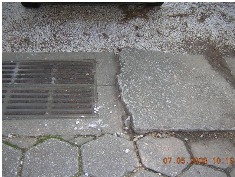
Foto 27: Calha de drenagem quebrada. (fonte: Autores)
