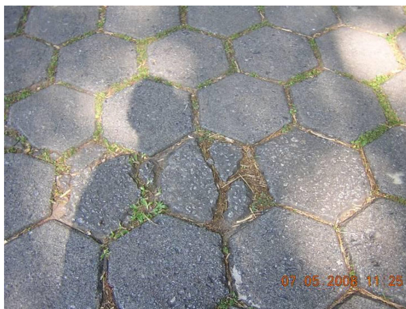
Foto 38: Bloco quebrado, com ninho preenchido de vegetação. (fonte: Autores)
