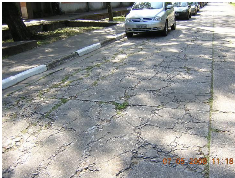
Foto 51: Placa de concreto completamente quebrada com ninho de vegetação. (fonte: Autores)
