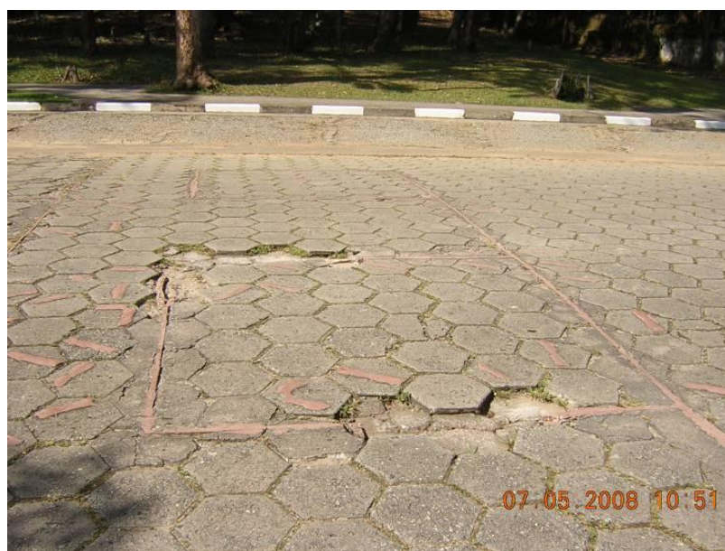
Foto 34: Resíduo de pintura asfáltica, com buracos devido à falta de blocos. (fonte: Autores)
