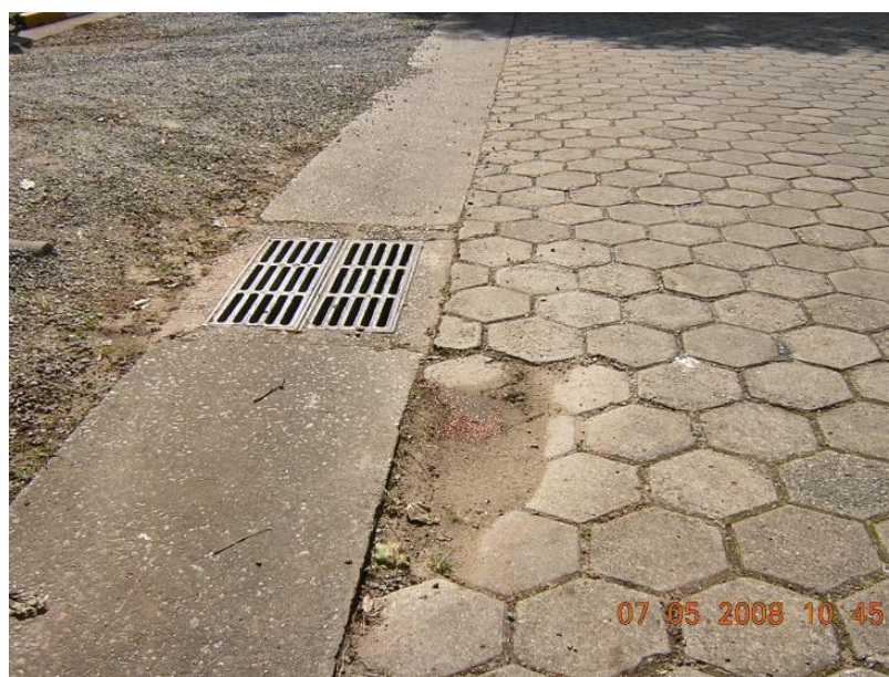
Foto 28: Desnível de borda e buracos. (fonte: Autores)
