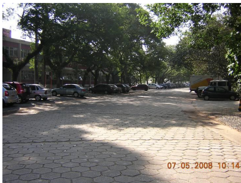
Foto 24: Desnível transversal. (fonte: Autores)
