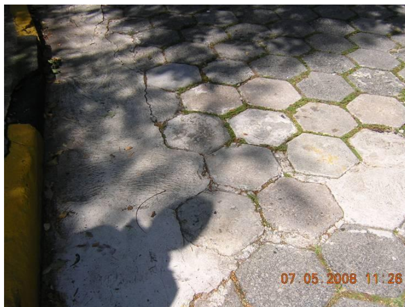
Foto 40: Reforma com substituição de tubulação enterrada, com revestimento diferente do original. (fonte: Autores)
