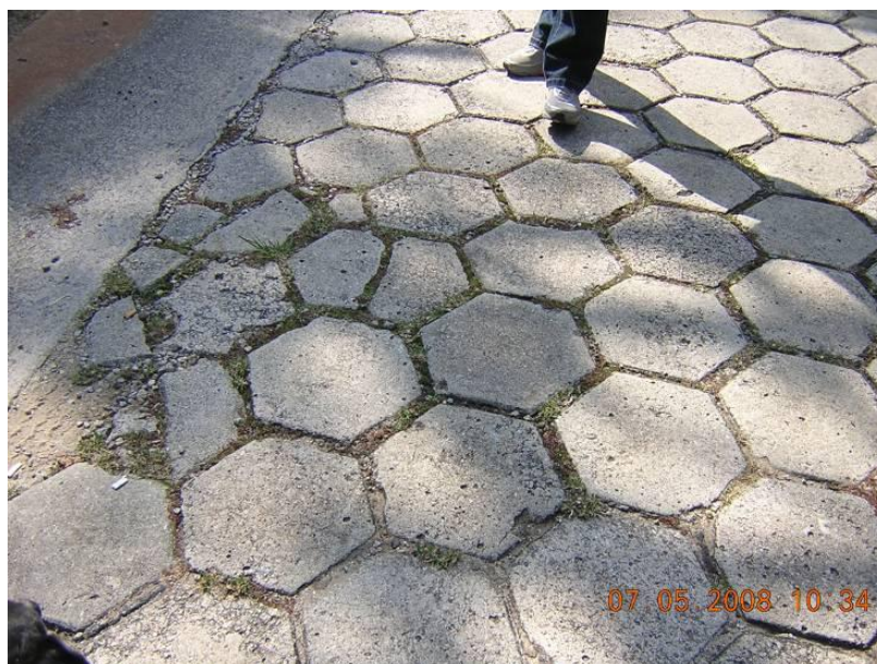
Foto 26: Quebra de Borda, Ninho com vegetação, Desgaste Superficial. (fonte: Autores)
