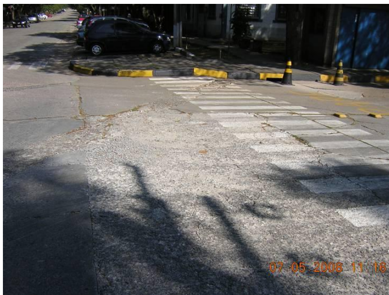
Foto 47: Rotatória – Trinca e quebra da placa de concreto. (fonte: Autores)
