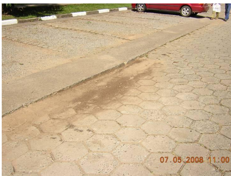
Foto 36: Desnível de Borda, desgaste de blocos. (fonte: Autores)
