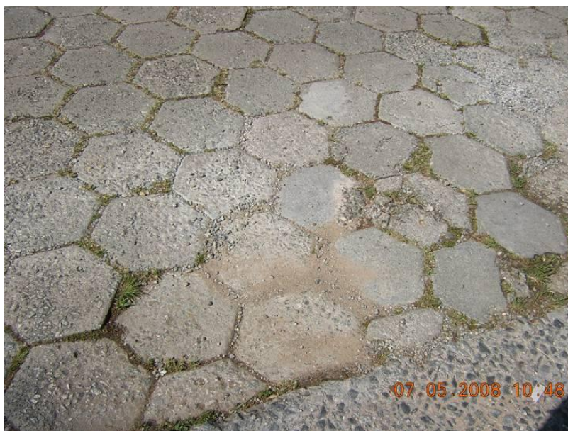
Foto 31: Ninhos preenchidos de vegetação, blocos com trinca de borda assim como blocos com bordas quebradas, desgaste superficial e blocos cobertos de resíduo de material. (fonte: Autores)
