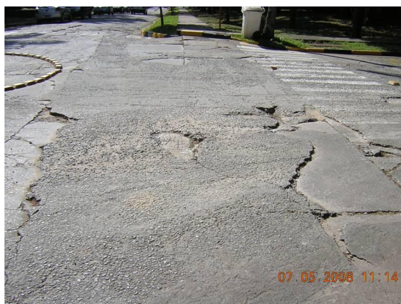
Foto 44: Rotatória – Trinca e quebra da placa de concreto. (fonte: Autores)
