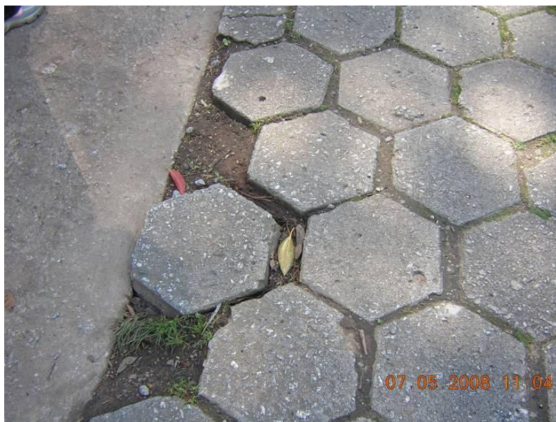
Foto 37: Desnível de borda, buraco devido à falta de blocos, assim como a presença de vazio. (fonte: Autores)
